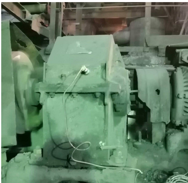
Рис. 7. Вибрационный датчик АС-102-1А, установленный на корпусе редуктора при проведении экспериментальных исследований
