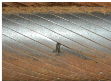
Рис. 8. Обрыв фасонной проволоки несущего каната закрытой конструкции
