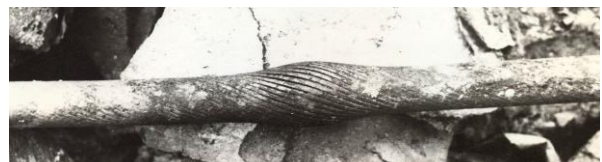
Рис. 13. Дефект несущего каната закрытой конструкции – местное увеличение диаметра каната
